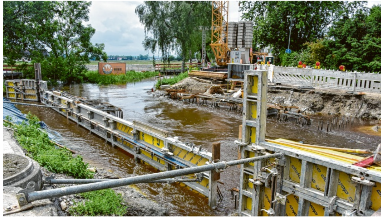
Die Baustelle der neuen Achbrücke am Erlengraben in Klingsmoos war vor wenigen Tagen noch trocken, jetzt ist sie komplett überflutet. Fotos: Andrea Hammerl
