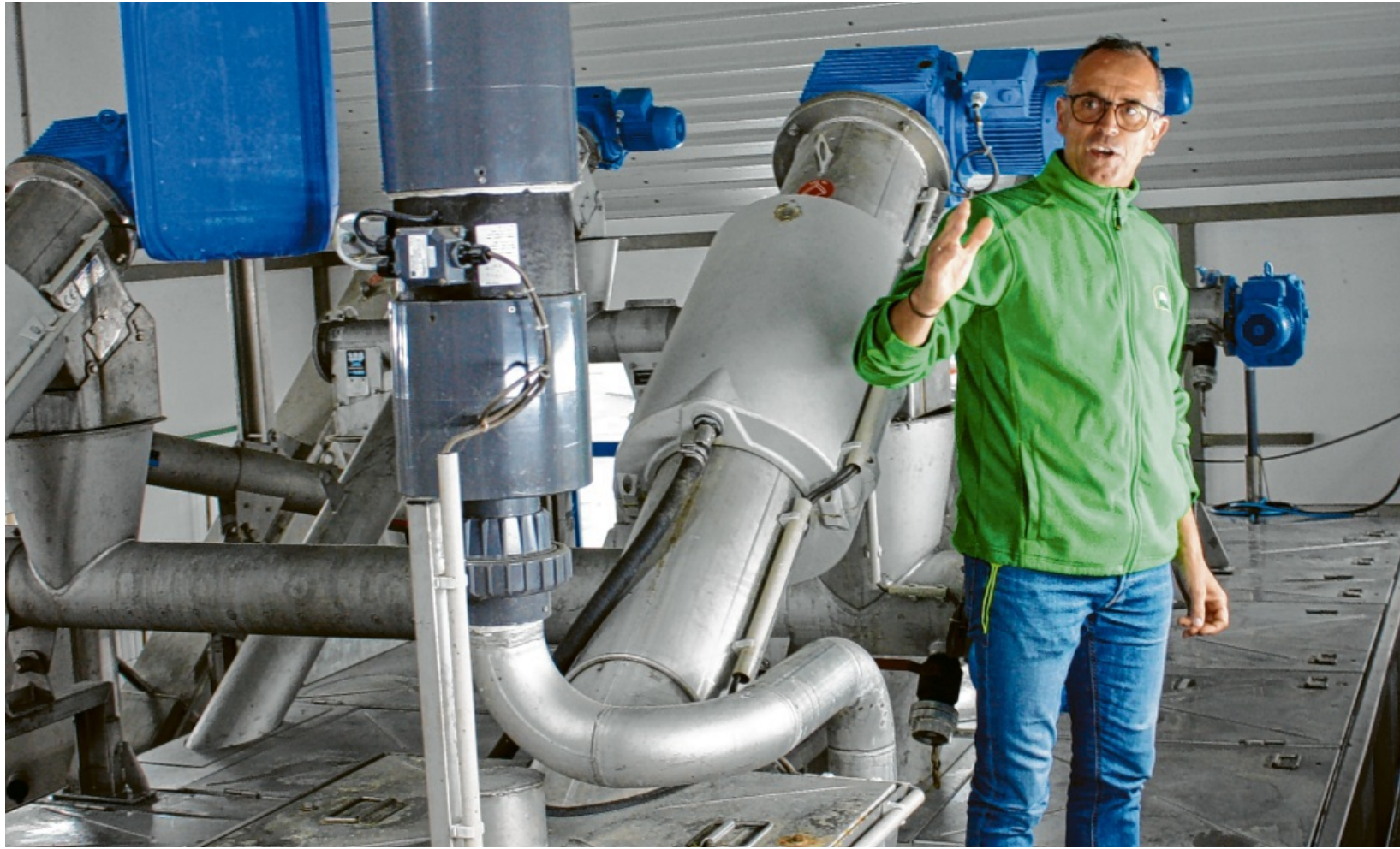
Betriebsleiter Robert Wiedemann führt durch die modernisierte Kläranlage Zusmarshausen. Kostenpunkt: rund vier Millionen Euro. Fotos: Thomas Hack
