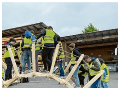
Die Schüler hatten mit großem Engagement eine selbsttragende kleine Brücke - die sogenannte Leonardo-Brücke - bei Fa.Holzbau Gump
