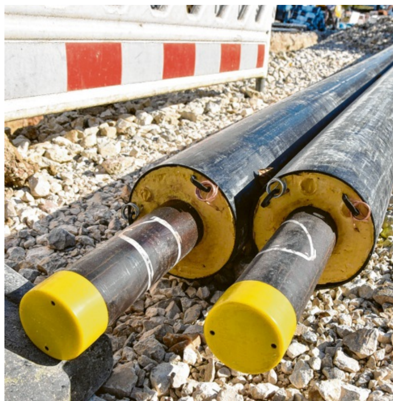
Zwei Anwohner der Manggasse in Oettingen wollen sich an die Nahwärme anschließen lassen. Foto: Wolfgang Widemann (Symbolbild)
