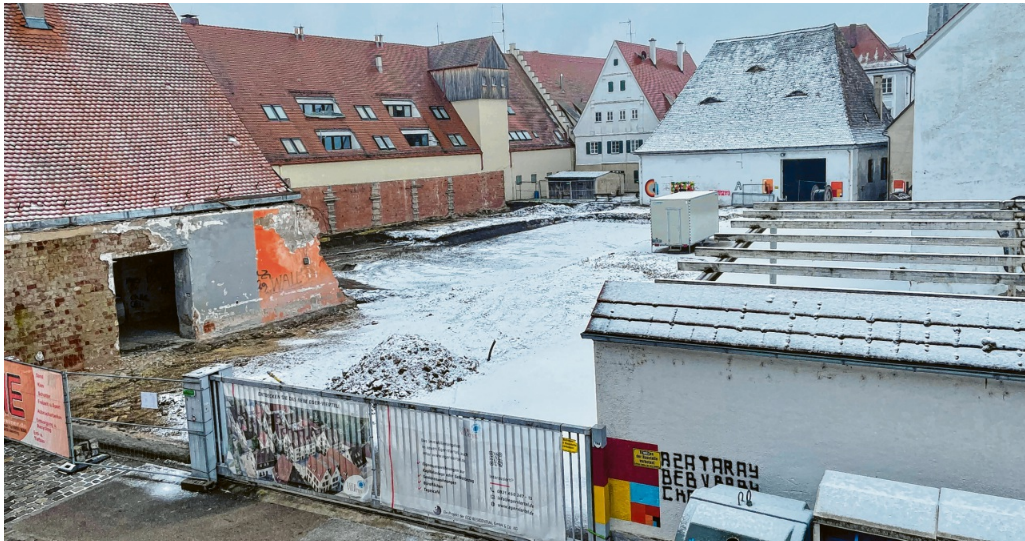
Der Blick von der Stadtmauer auf das ehemalige Ankerbräu-Gelände: Die Baugrube für die neue Kita ist bereits ausgehoben. Foto: Martina Bachmann
